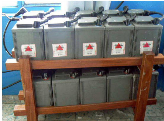
FIGURA 1.34.- BANCO DE BATERÍAS
