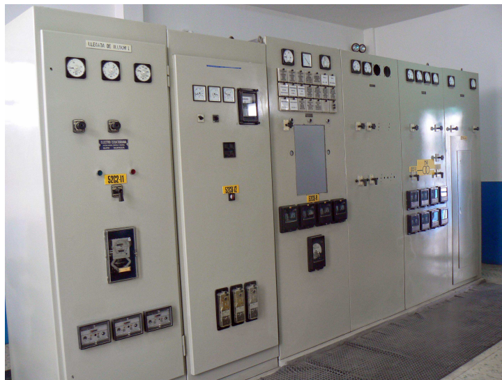
FIGURA 1.33.- CUARTO DE CONTROL
