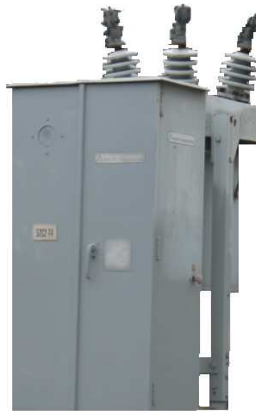
FIGURA 1.19.- RECONECTADOR O RESTAURADOR
