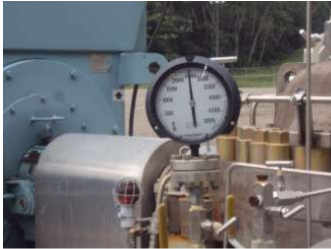
Figura 2.5 Manómetro a la descarga de la bomba
