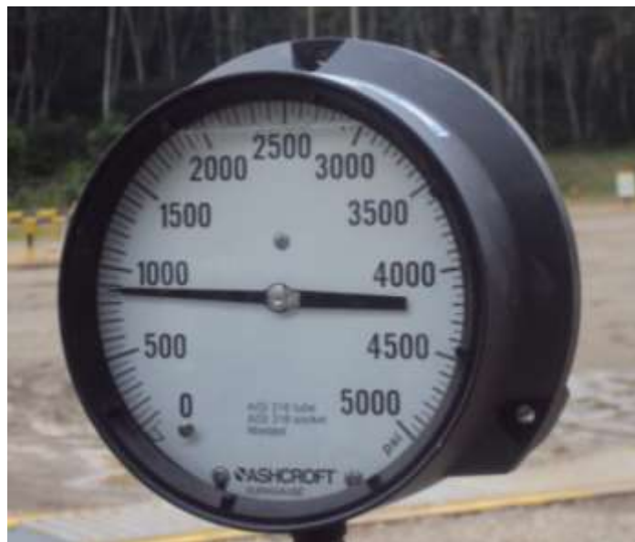
Figura 2.4 Manómetro a la succión de la bomba
