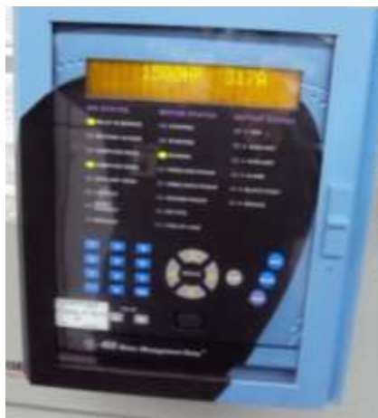
Figura 2.7 Relé de seguridad Multilin 469
