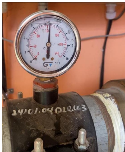
ANEXO I6: MEDICIÓN DE PRESIÓN EN EL SISTEMA DE BOMBEO.
