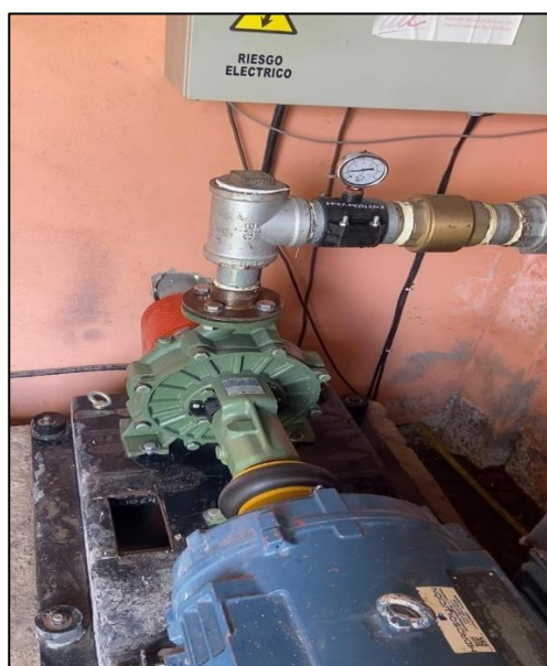
ANEXO D2: DIAGNÓSTICO DEL ESTADO DE OPERACIÓN DEL SISTEMA DE BOMBEO.
