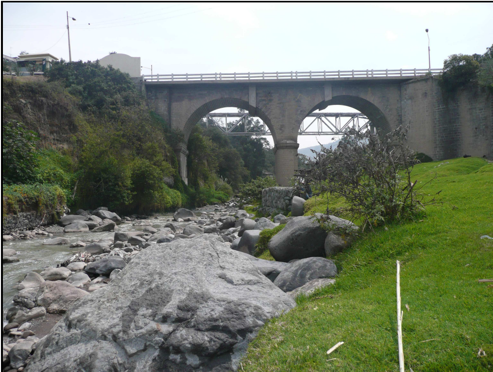
Fotografía 17: Río Ambato, Sector del Socavón
