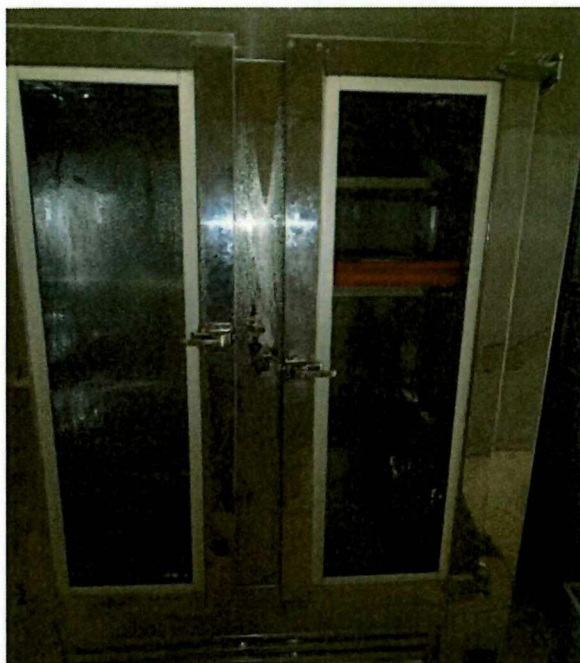
Fotografía No. 12. Refrigeración
