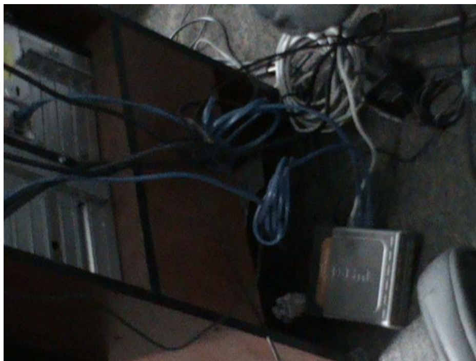
CONEXIÓN DE CABLES DE TELEFONO FIJOS
