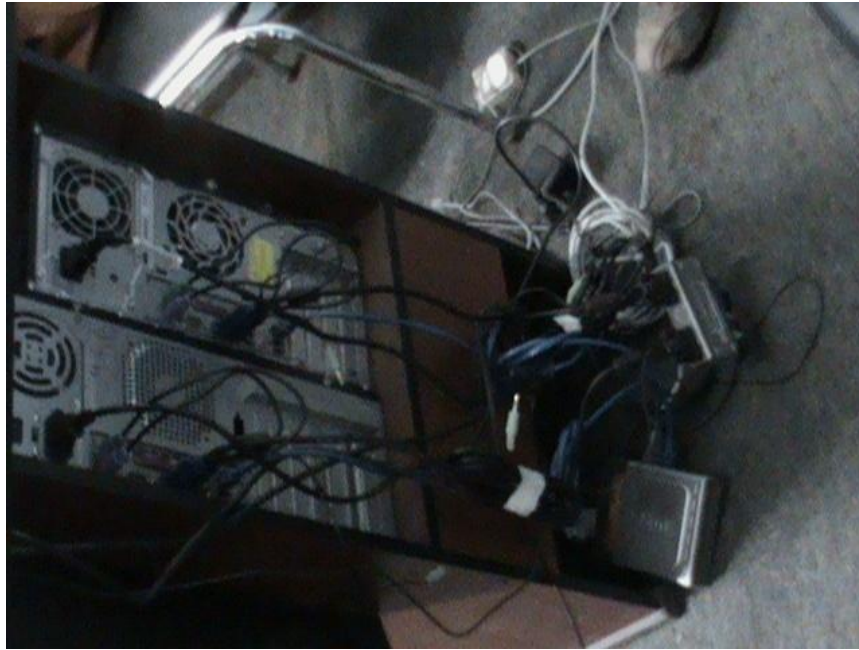
COMPROBACION DE FUNCIONAMIENTO DEL SERVIDOR
