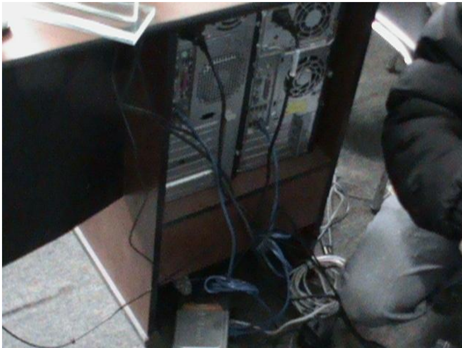
CONEXIÓN DE CABLES AL SERVIDOR
