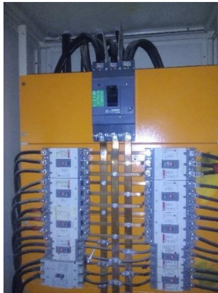
Figura 8. Tablero principal del bloque A.
