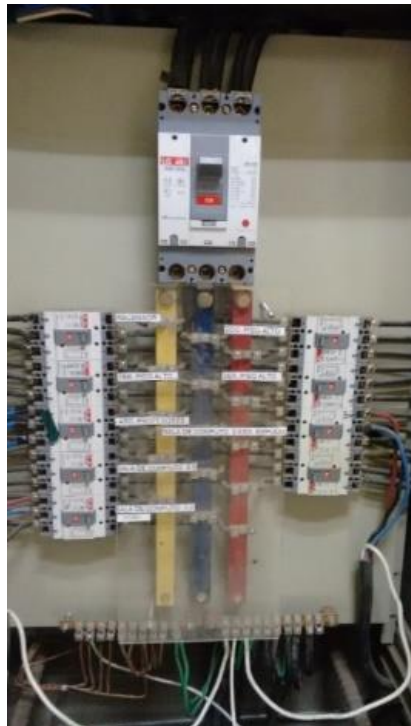
Figura 7. Tablero principal del bloque B.
