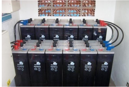
Figura 1.36 BATERÍAS ESTACIONARIAS UTILIZADAS EN INSTALACIONES FOTOVOLTAICAS.
