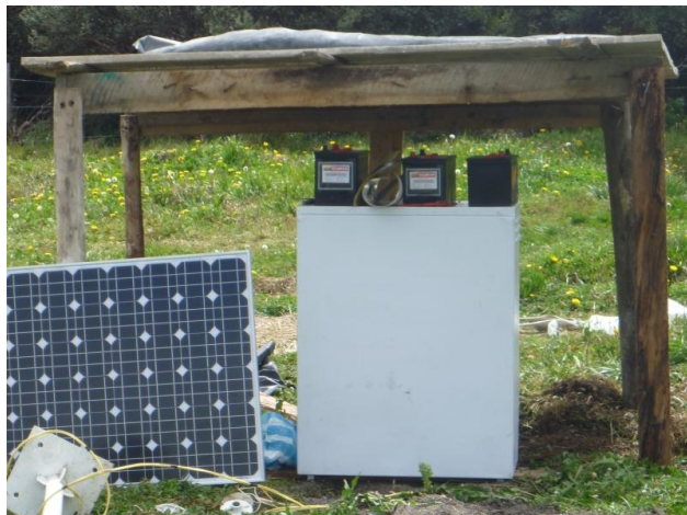
Figura 3.29 ESTRUCTURA PARA EL MÓDULO FOTOVOLTAICO.
