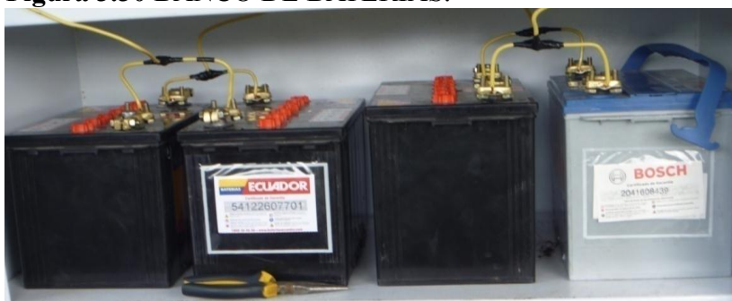
Figura 3.30 BANCO DE BATERÍAS.
