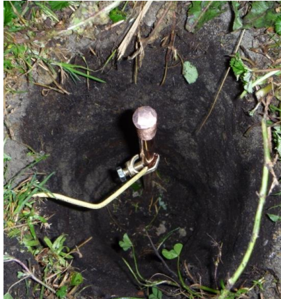
Figura 3.32 CONEXIÓN A TIERRA.
