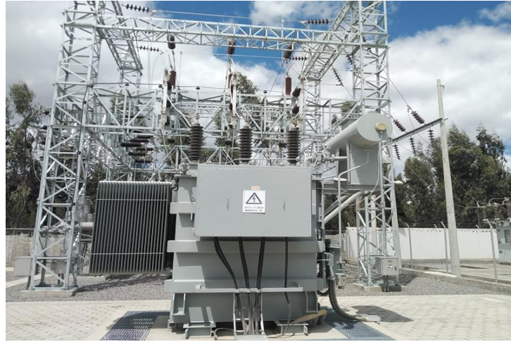
Fig. 31. Transformador de Potencia de la subestación Pujilí.
