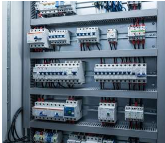
Figura 11. Panel de protecciones eléctricas contra sobretensión
