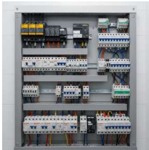
Figura 18. Tablero de protecciones eléctricas con fusibles, disyuntores y protectores para la sobretensión
