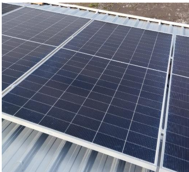
Figura 16 Paneles solares instalados en la parte superior del techo de la vivienda.
