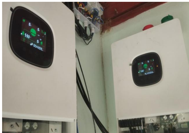
Figura 24 Inversores en el área de funcionamiento.
