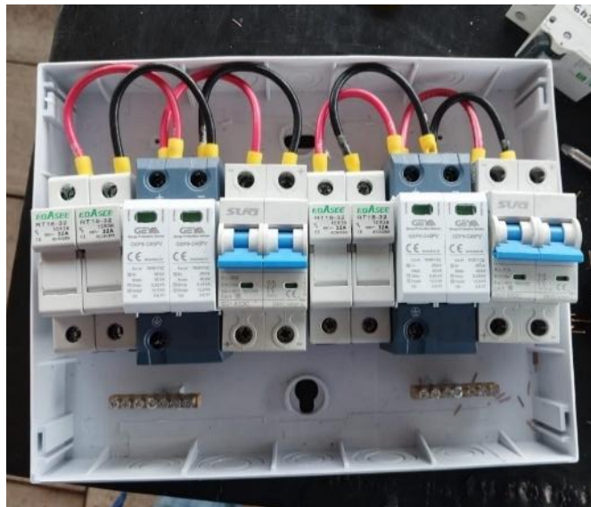
Figura 17 Protecciones sistema fotovoltaico en condiciones reales en la instalación.
