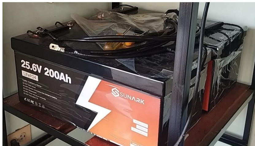
Figura 19 Baterías del sistema fotovoltaico.
