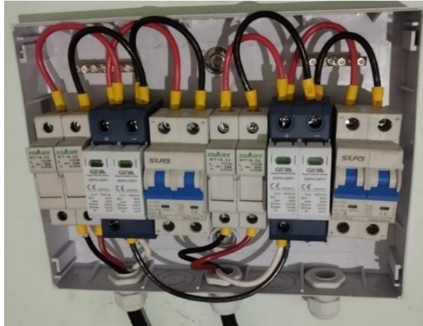
Figuras 23 Elementos de protección instalados.
