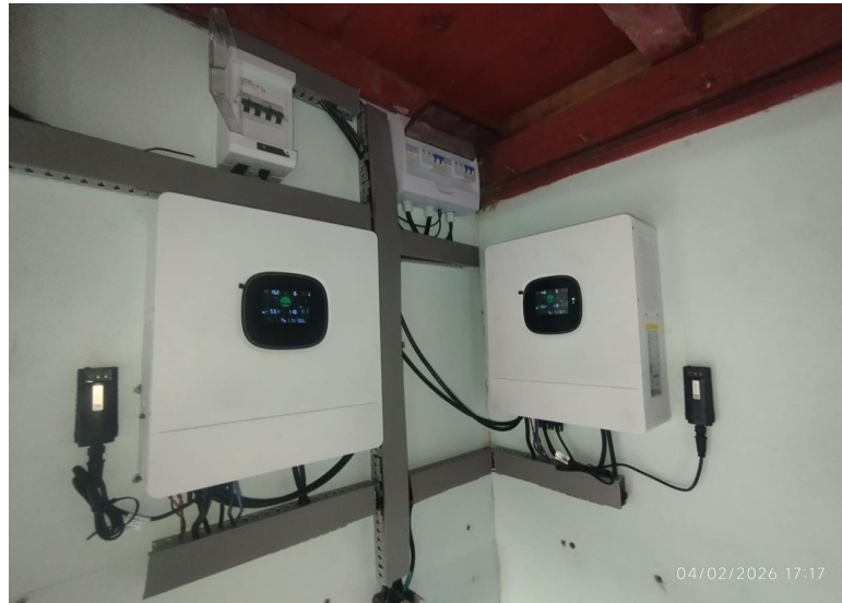
Figura 18 Inversores ubicados en su lugar de operación.
