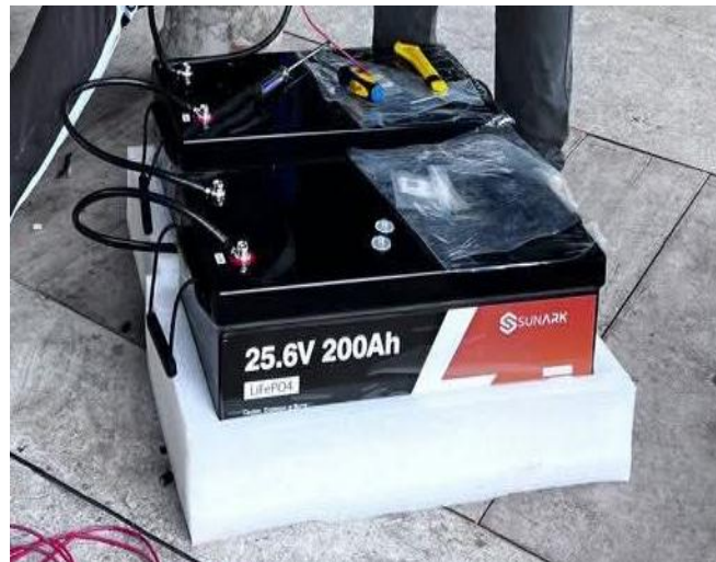
Figura 26 Banco de baterías.
