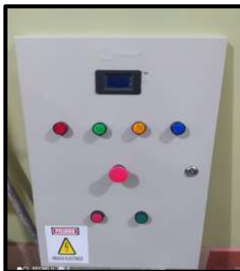
Figura 4.28 Tablero de control energizado.
