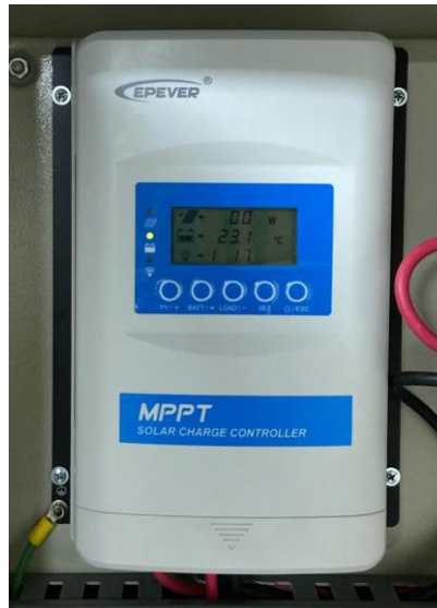
Figura 4.16. Regulador de carga marca EPEVER MPPT
