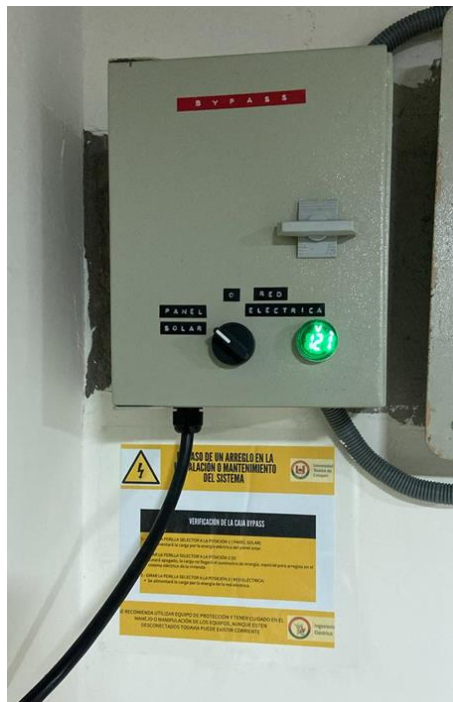
Figura 8.50. Bypass con su señalética.
