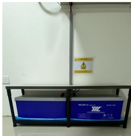
Figura 8.49. Baterías JYC con su señalética.
