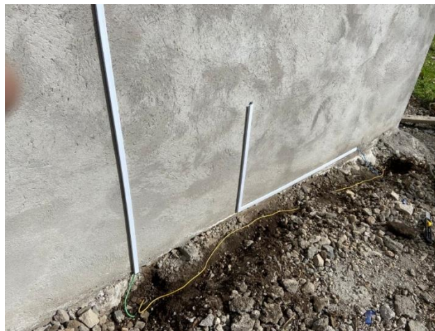
Figura 5.34. Instalación de puesta a tierra para protección de los sistemas eléctricos
