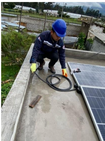
Figura 8.39. Conexión de paneles fotovoltaicos (Triana- Vertex)
