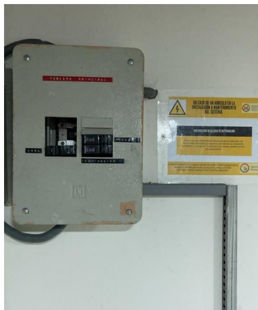
Figura 8.51. Caja de distribución con su señalética.
