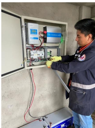
Figura 8.45. Conexiones internas gabinete fotovoltaico.
