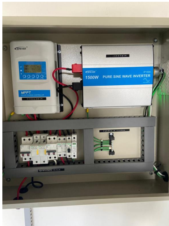
Figura 8.47. Gabinete fotovoltaico, con su etiquetado.
