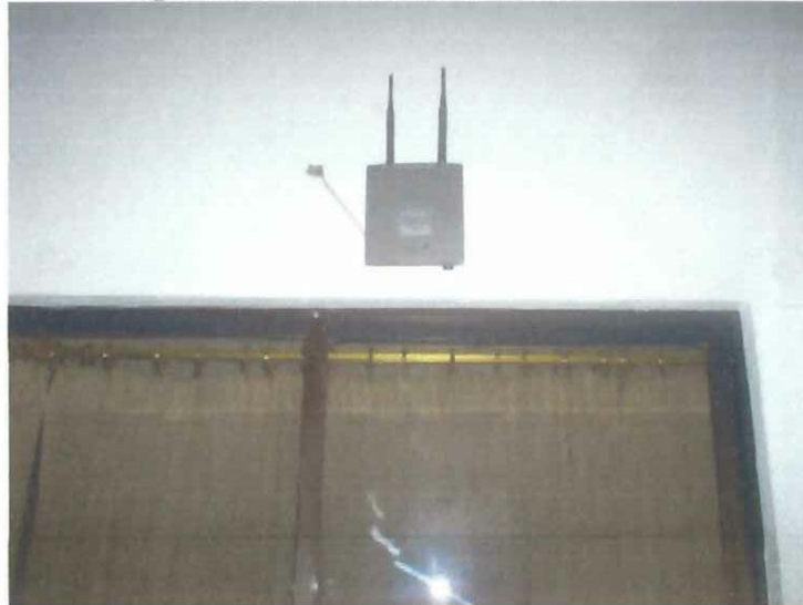
Figura 29: Ubicación de los Access Point.
