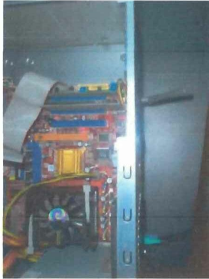
Figura 35: Instalación de las tarjeta de Red
