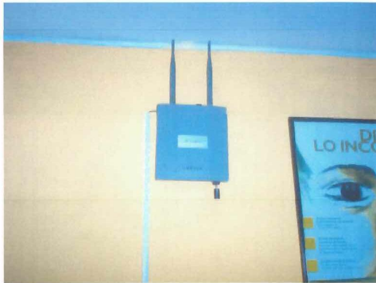
Figura 28: Ubicación de los Access Point
