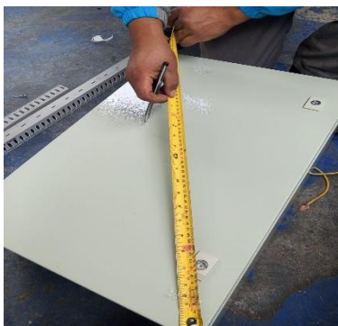
Figura N.1 Cortes en el tablero de control
