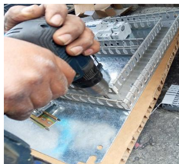
Figura R.1 Perforación de la base metálica del tablero eléctrico
