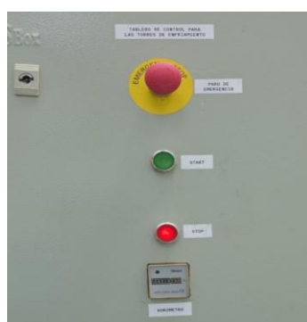
Figura 5.11 Tablero de control del sistema automatizado de bombeo
