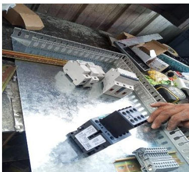
Figura S.1 Montaje de componentes eléctricos.
