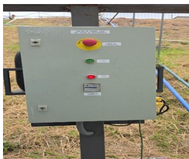
Figura EE.1 Tablero de control finalizado
