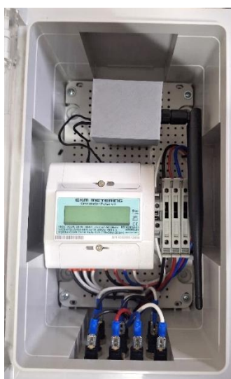
Figura 5.1 Implementación del registrador de parámetros eléctricos en tablero
