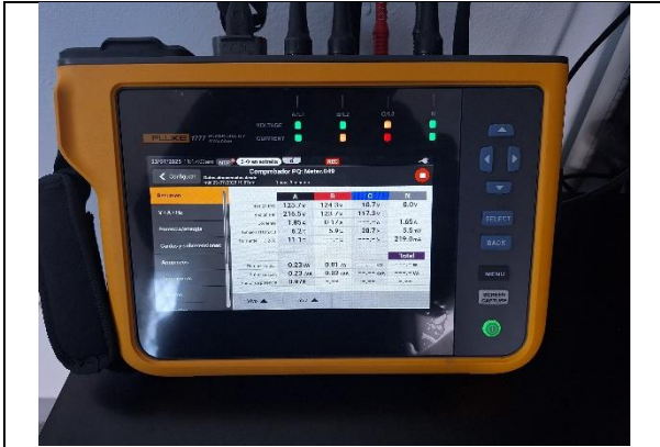
Medición de parámetros eléctricos con equipos Fluke
