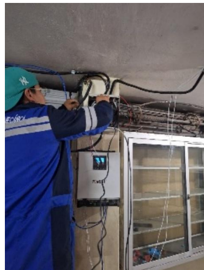
Instalación del equipo emisor en el tablero de distribución del usuario comercial
