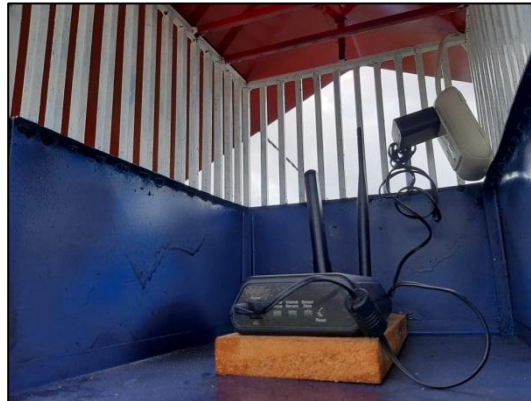
Figura 17: Infraestructura para la instalación del Gateway
