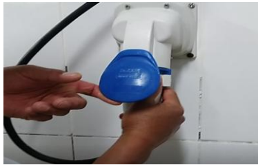
Fotografía de la válvula abierta de ingreso de vapor
