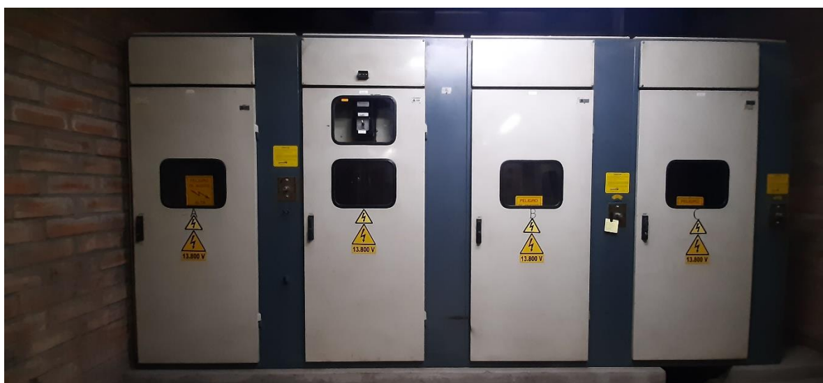
Anexo 9: Celda seccionadores fusibles de medio voltaje.
