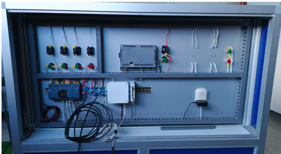
Figura 5. 2. Tablero de control parte posterior
