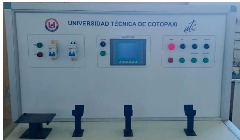
Figura 5. 1. Modelo final del Tablero de Control
