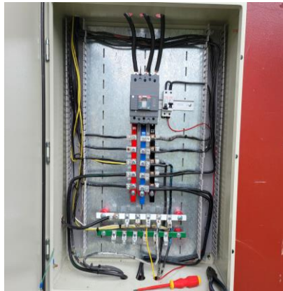
Figura 25. Tablero eléctrico distribución principal TDP
