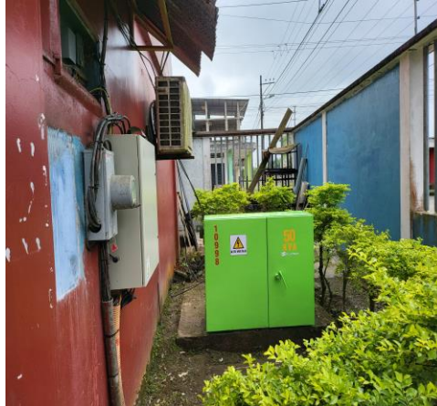
Figura 31. Transformador de potencia 50 KVA reacondicionado
