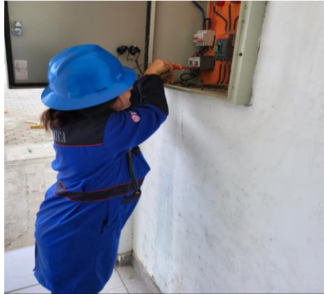
Figura 26. Cambio de mandos y selectores
