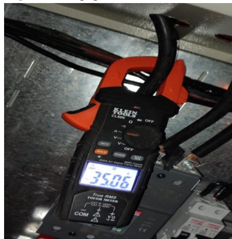
Figura 22. Equipos de medición Pinza Amperimétrica
