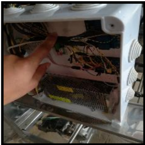
Figura N9. Ubicación del sistema eléctrico y de control.
