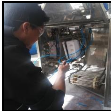
Figura N10. Ubicación del sistema neumático.
