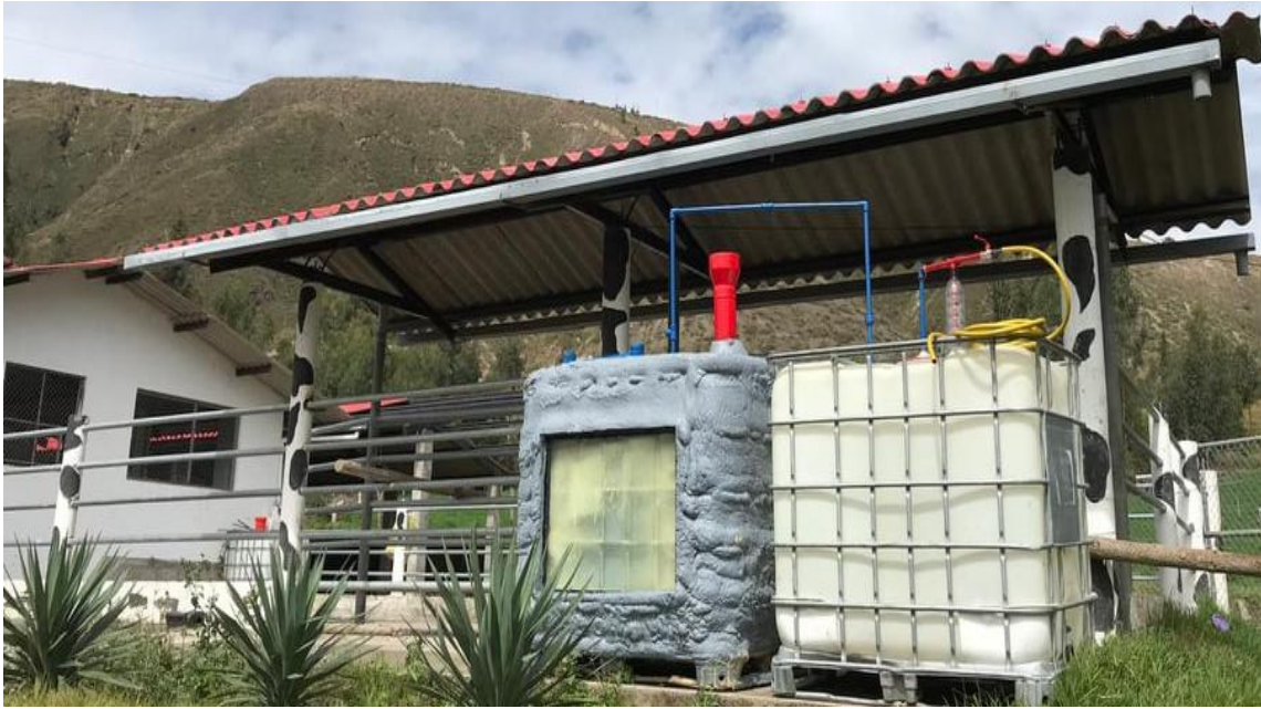
Ilustración 27. Biodigestor instalado en el establo de ordeño
