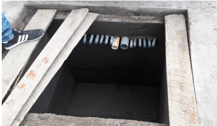
Figura 19 Pozo recolector de agua y tubería de entrada de los chorros
