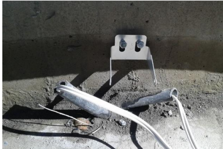
Figura 27 Bases de las luminarias.
