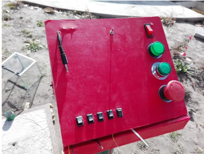
Figura 24 Modulo de control y potencia
