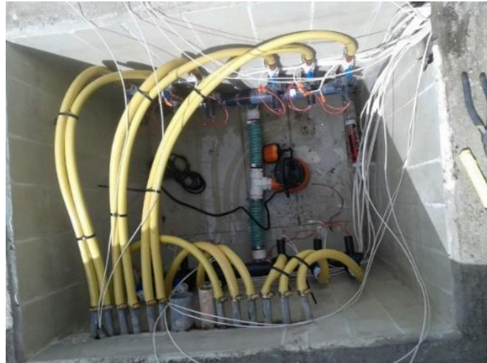
Figura 26 Empotramiento de bomba, tubería y cableado de control, potencia e iluminación.
