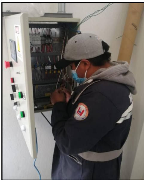
Figura 4.33. Conexión de los equipos en el tablero de control.
