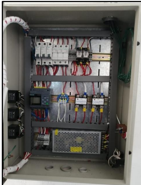
Figura 4.21. Instalación interna del tablero de control.
