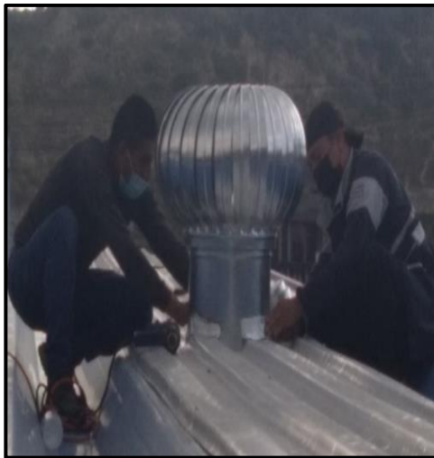
Figura 4.9. Ubicación del extractor eólico.
