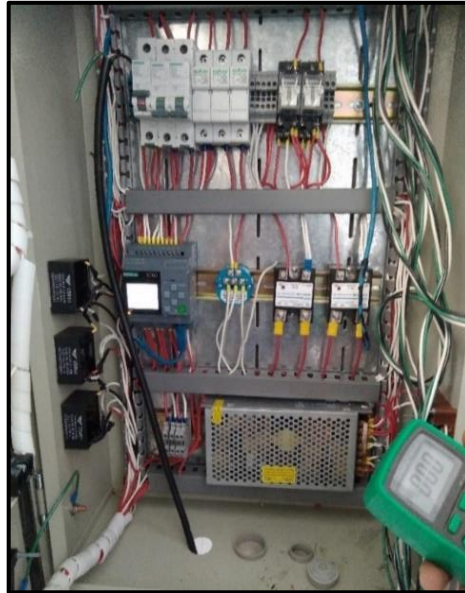
Figura 4.22. Encendido del tablero de control.
