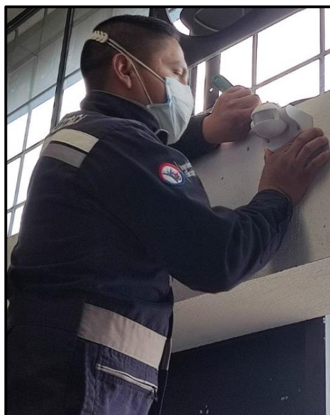
Figura 4.29. Conexión del sensor de movimiento.
