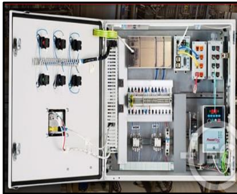
Figura 3.30. Tablero eléctrico industrial [36].
