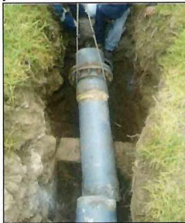
Figura 91 Corte y Extracción de la Tubería de Presión Dañada.
