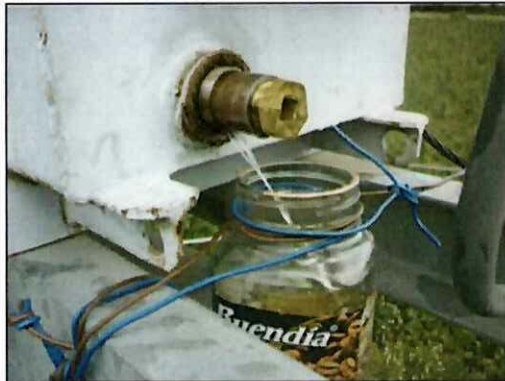
Figura 129 Toma de Muestras de los Transformadores Elevador y Reductor.
