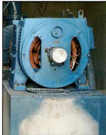
Figura 53 Generador Trifásico AEG
