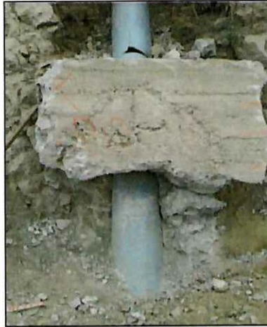
FUENTE: Tubería de Presión AUTORES: CRUZ CÉSAR, AVILÉS MIGUEL
