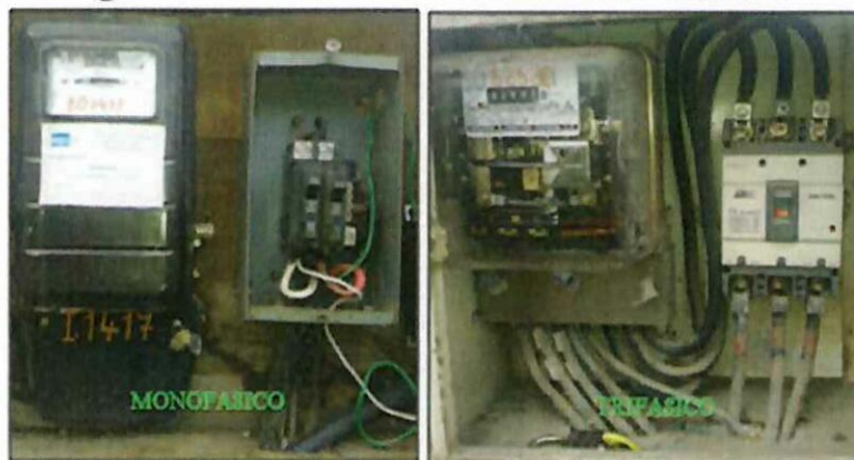
Figura 62 Detalle de los Medidores del Monasterio
