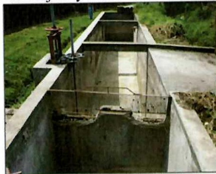
Figura 42 Rejilla y Muro de Concreto Fisurado.
