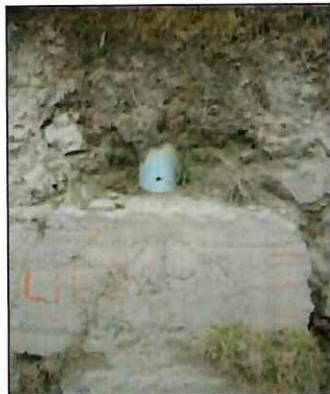
Figura 45 Tubería de Presión Fisurada
