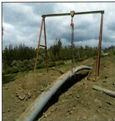
FUENTE: Tubería de Presión AUTORES: CRUZ CÉSAR, AVILÉS MIGUEL
