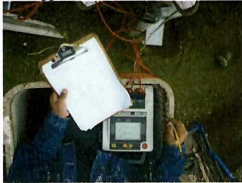
Figura 131 Meggado en el Transformador Reductor AEG
