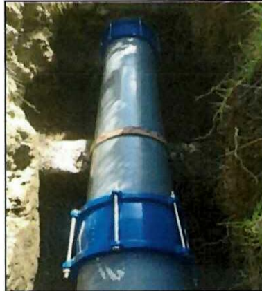
FUENTE: Tubería de Presión AUTORES: CRUZ CÉSAR, AVILÉS MIGUEL
