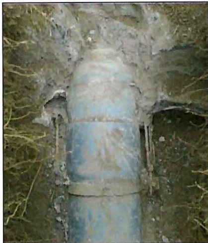
FUENTE: Tubería de Presión AUTORES: CRUZ CÉSAR, AVILÉS MIGUEL
