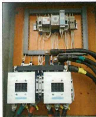
Figura 104 Tablero de Transferencia
