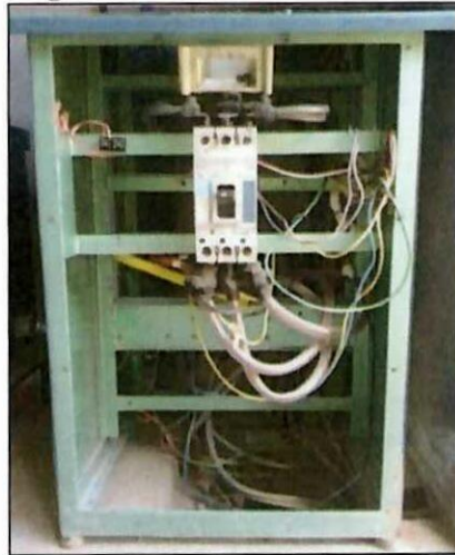
Figura 49 Tablero de Control
