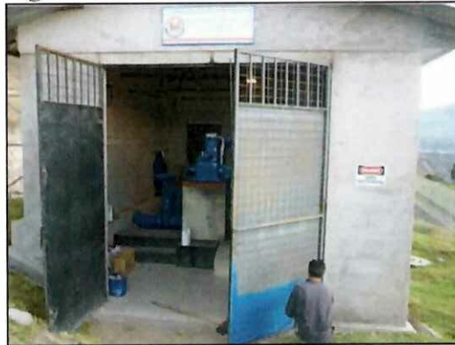
FUENTE: Casa de Máquinas AUTORES: CRUZ CÉSAR, AVILÉS MIGUEL
