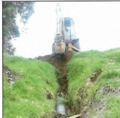
FUENTE: Tubería de Presión AUTORES: CRUZ CÉSAR, AVILÉS MIGUEL
