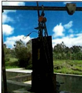
Figura 44 Compuerta Deslizante de los Desarenadores.
