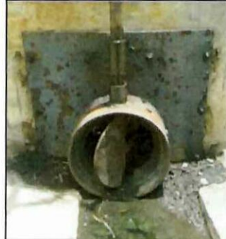
Figura 43 Válvula de Mariposa de los Desarenadores.
