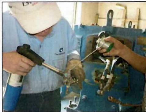
Figura 114 Acondicionamiento de Cables de Salida del Generador.
