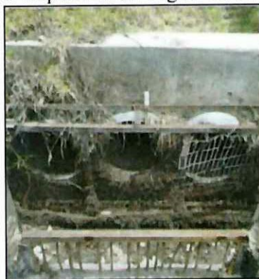
Figura 40 Captación de Agua en Mal Estado
