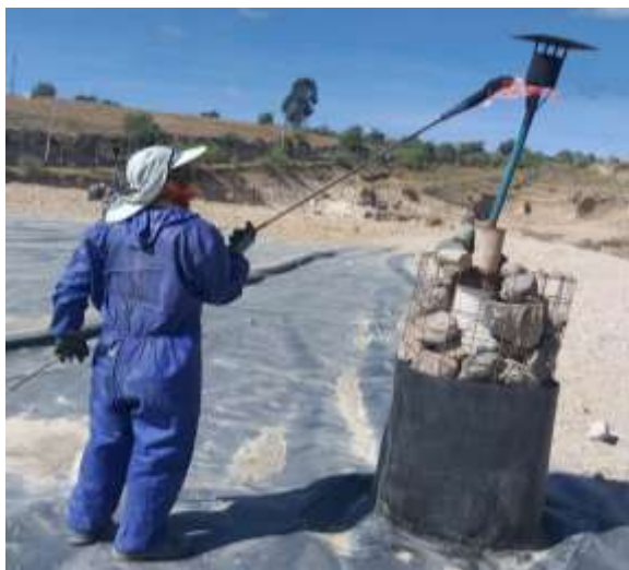
Figura 5. Venteo de biogás Latacunga [28].
