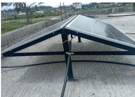
Figura 4.7. Implementación de paneles solares en el techo de la vivienda.
