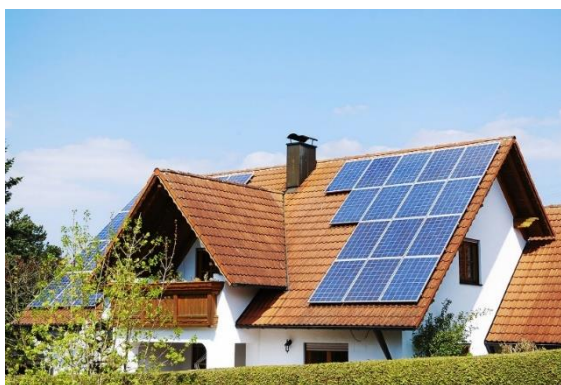
Figura 3.2. Paneles solares ubicados en el techo de una vivienda [12].
