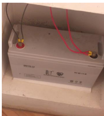
Figura 4.10. Conexión del banco de baterías.
