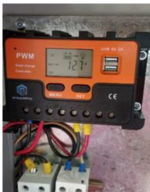
Figura 4.8. Controlador de carga instalado en el hogar piloto.
