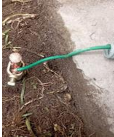
Figura 8.6. Conexión del conductor a la puesta a tierra.
