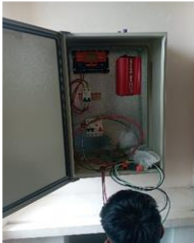
Figura 8.4. Cableado de los equipos.
