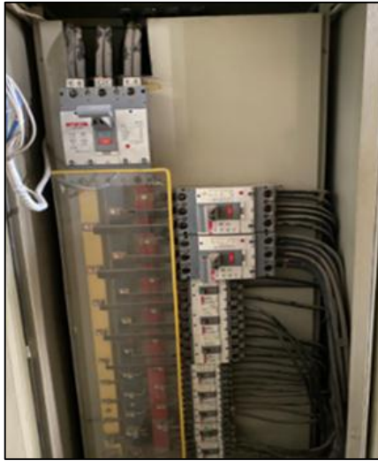
Figura 4.3. Tablero de distribución principal.
