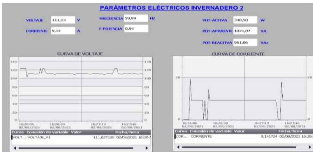
Figura 35. Subpantalla de datos de parámetros eléctricos
