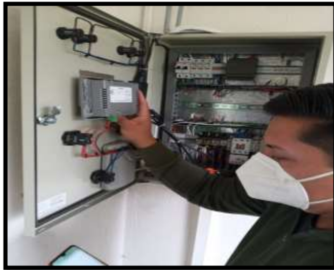
Anexo VII. Comprobación del funcionamiento de la pantalla HMI
