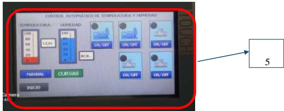
Imagen 5. Pantalla del sistema de control Manual.
