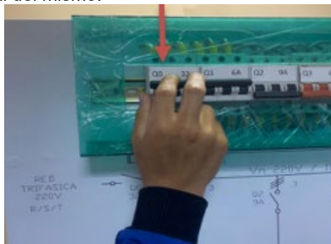
Figura 2. Accionamiento del breaker Q0
