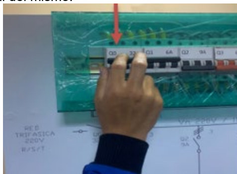
Figura 2. Accionamiento del breaker Q0
