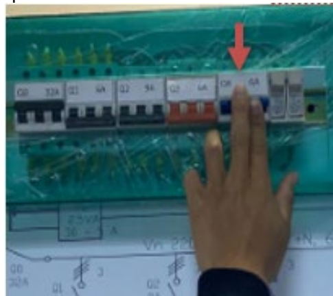
Figura 7. Accionamiento del breaker Q4
