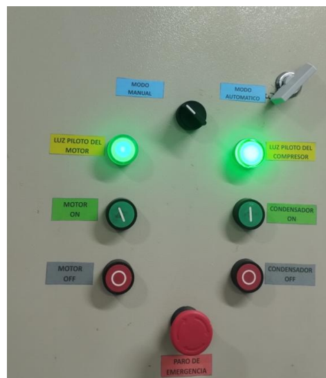
Figura 5.25. Luces pilotos encendidas
