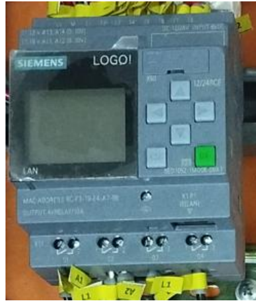
Figura 5.10. Instalación de PLC LOGO
