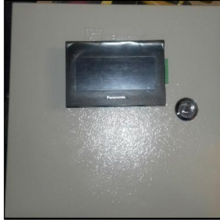
Figura 21. Pantalla HMI instalada
