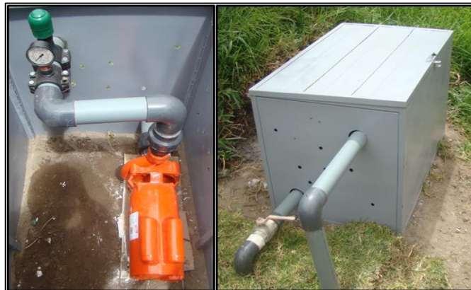
Figura 17. Bomba de agua EVANS 3HP y caja de protección
