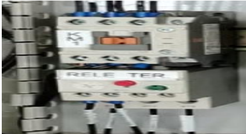
Figura 3. Relés térmicos en entorno industrial
