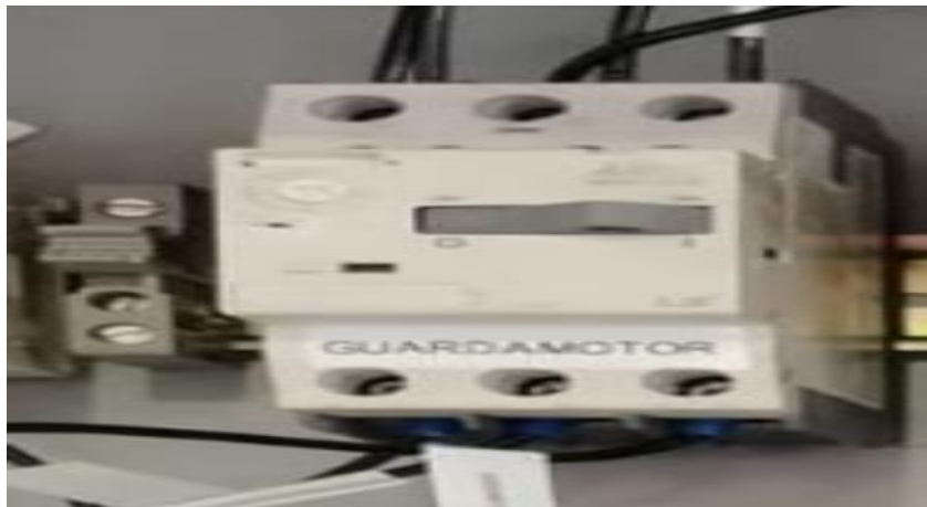
Figura 4. Guardamotores industriales junto a panel metálico
