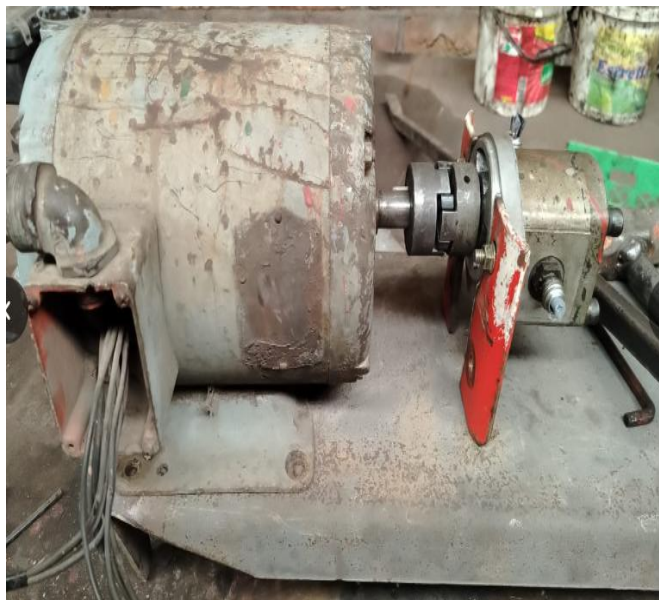
Figura 2: Mantenimiento del motor
