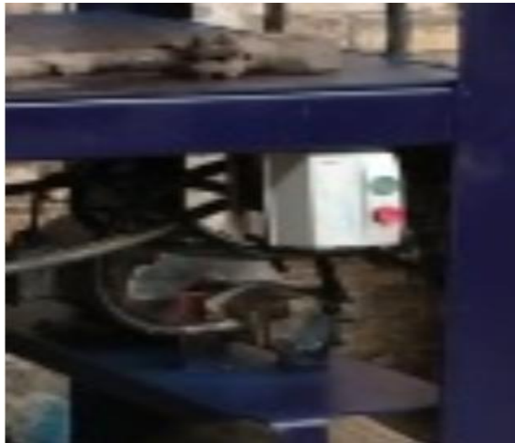
Ilustración 4 Mando eléctrico de la prensa.
