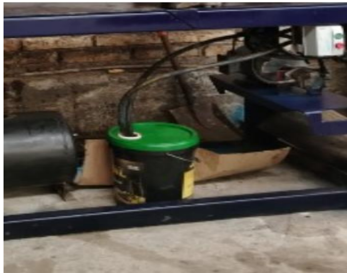
Ilustración 3: Unidad hidráulica motor y depósito
