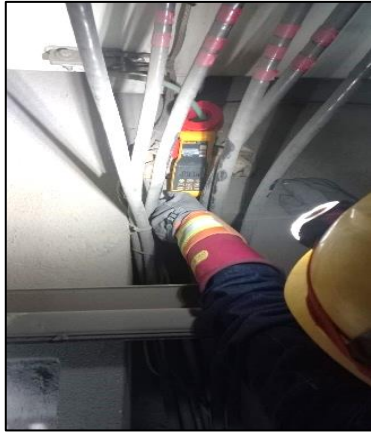
a) Puestas de tierra individual de transformadores.
