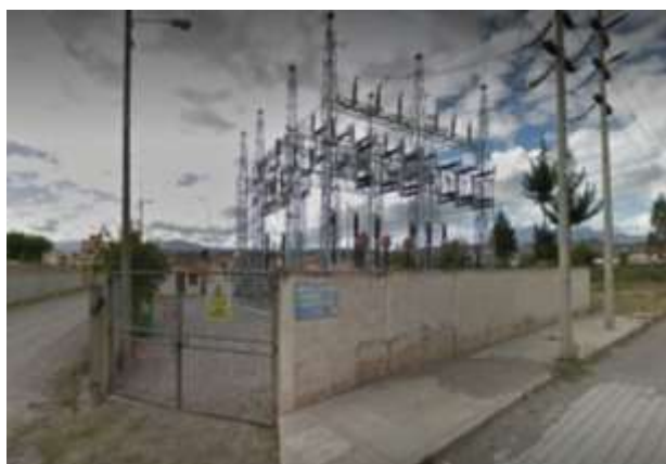
Figura 4.1 Subestación N° 4 Tapi de la EERSA.
