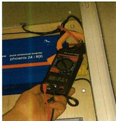
FIGURA 3. 18 Medición de corriente en el sistema de inversión eléctrica de la vivienda
