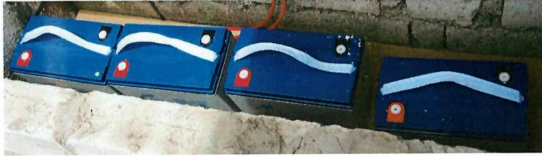
FIGURA 3. 2 Banco de baterías Ritar RA 6-200D (6V200)
