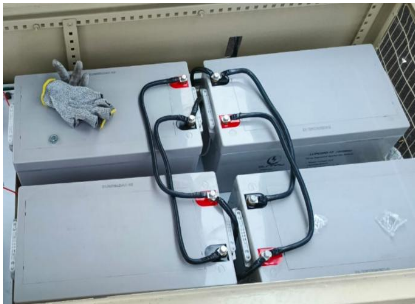
Figura 7. Almacenamiento de energía generada por paneles solares.
