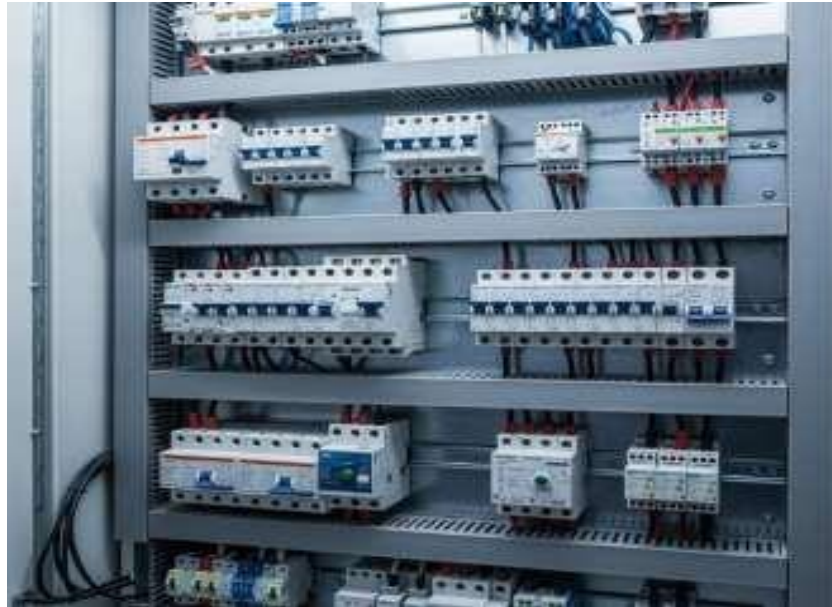
Figura 17. Panel de protecciones eléctricas contra sobretensión.
