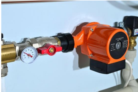
Figura 13. Bomba de circulación y demás componentes [29].
