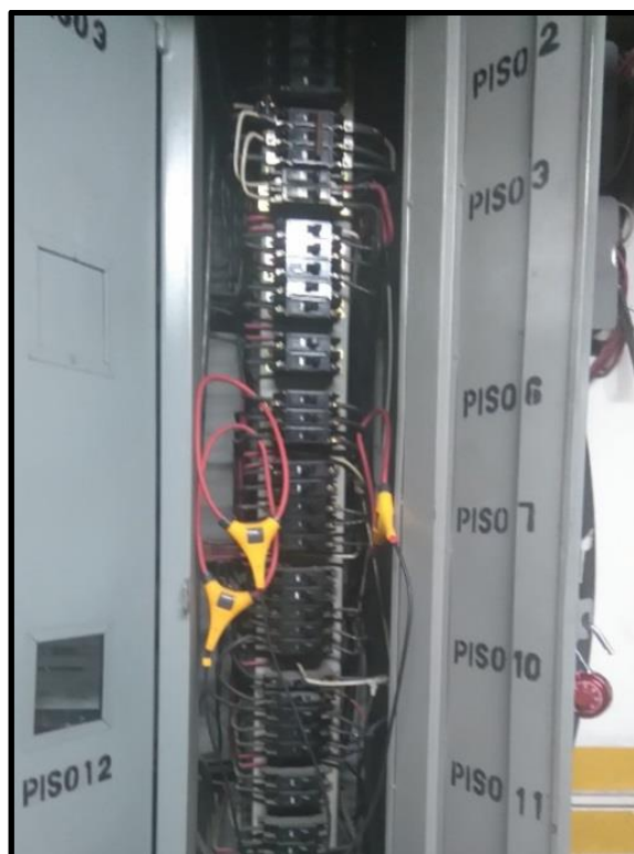
Figura 3.2 Tablero de medidores
