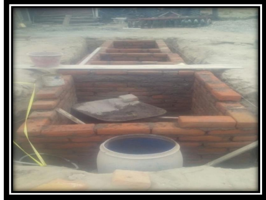
Estructura del Sistema de Tratamiento
