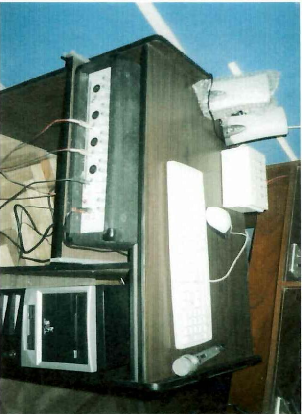
FIG. 2 IMPLEMENTACION DEL PANEL DE CONTROL
