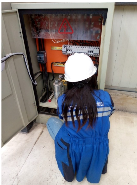
Figura F.1. Inspección técnica del banco automático de capacitores.
