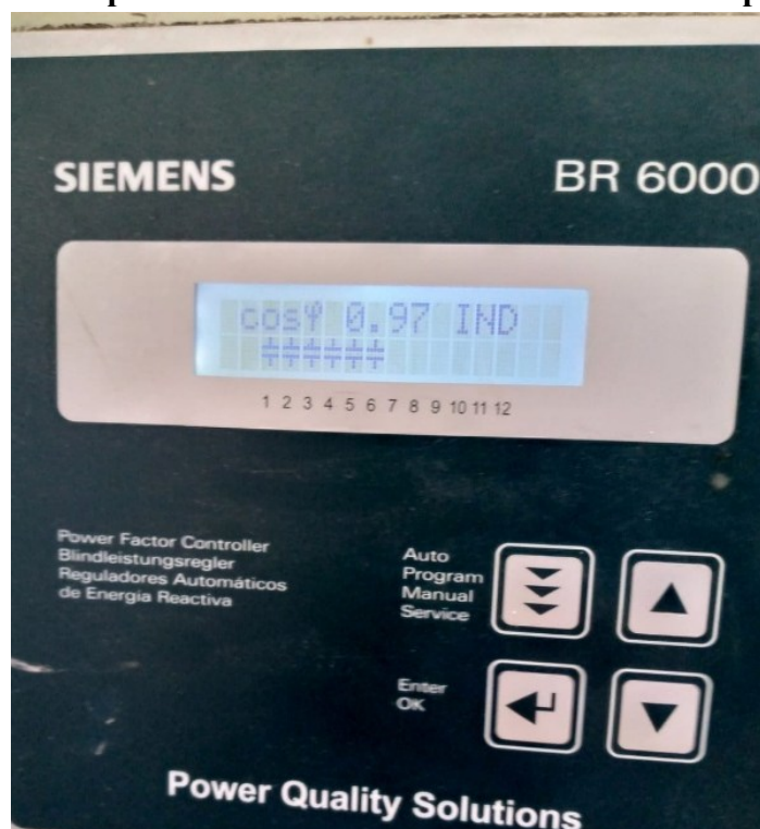
Figura F.2. Controlador de factor de potencia Siemens BR600 del banco automático de capacitores.
