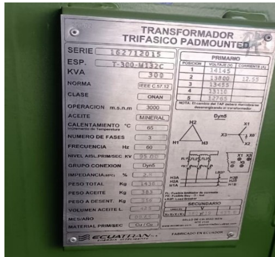
Figura F.1. Placa del transformador de la planta de pintura 300kVA
