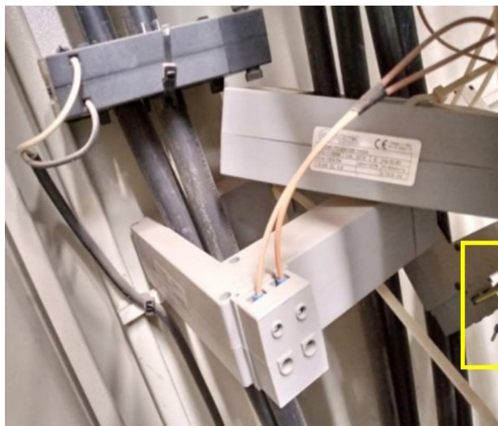
Figura I.2. Transformadores de corriente instalados en el tablero principal.
