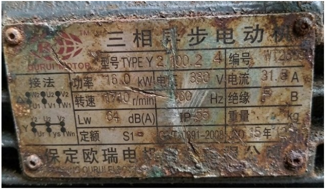
Figura F.7. Placa del motor del extractor 1
