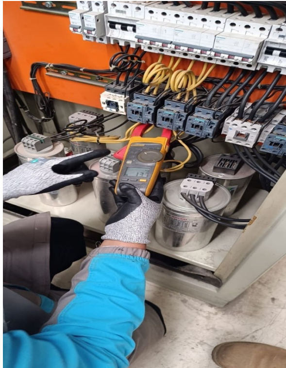
Figura F.3. Medición de los parámetros eléctricos de los capacitores instalados.
