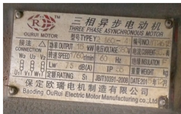
Figura F.3. Placa del motor del extractor de preparación
