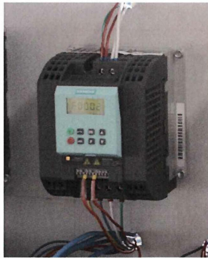
Figura 3.10 Convertidores de Voltaje
