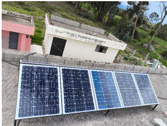
Figura 5.5 Estructura y paneles fotovoltaicos
