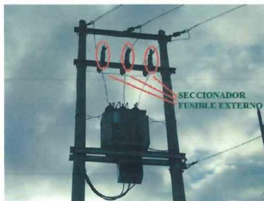
FIGURA N° 1-2; TRANSFORMADOR DE DISTRIBUCIÓN PROTEGIDO MEDIANTE SECCIONADORES FUSIBLES EXTERNOS.
