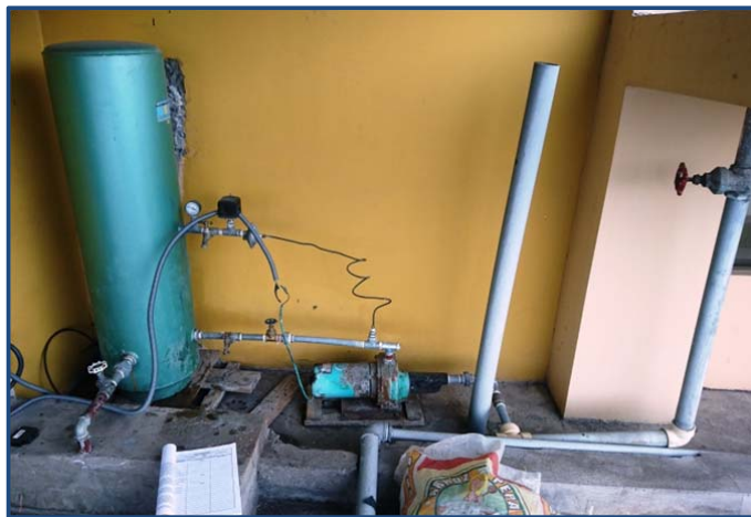
Figura 3.7 Equipo hidroneumático 2 – agua caliente
