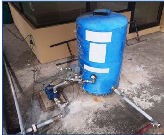
Figura 3.6 Equipo hidroneumático 1 – agua fría
