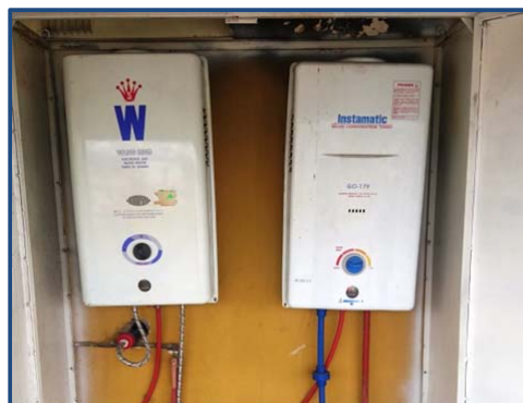
Figura 3.8 Calentadores de agua del hotel El Libertador
