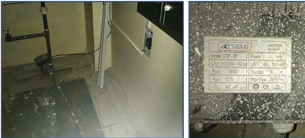
Figura 3.4 Bomba de agua de la cisterna
