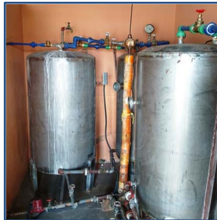
Figura 3.9 Tanques de almacenamiento de agua caliente
