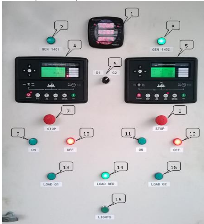
Grafico N° 2: Identificación de elementos en Tablero KUHSE
