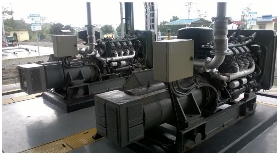
Figura 4. 37: Grupos electrógenos automatizados Fuente: EP Petroecuador (2016)
