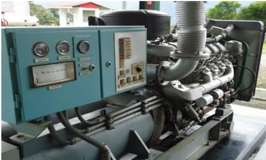
Figura 3. 8: Tablero de control y monitoreo de grupos electrógenos Fuente: EP Petroecuador (2015)
