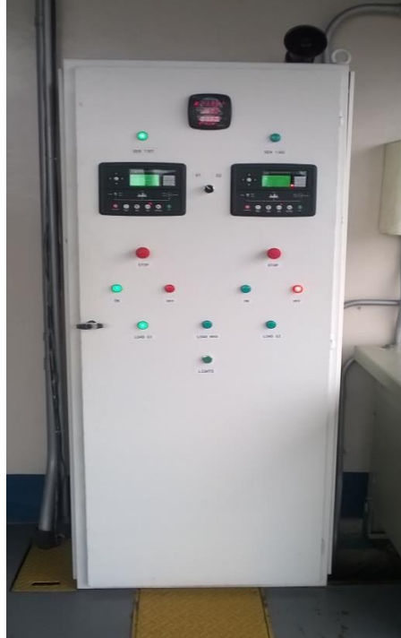
Figura 4. 36: Tablero de transferencia implementado Fuente: EP Petroecuador (2016)
