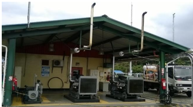
Figura 2. 1: Sala de generación estación Quijos Fuente: EP Petroecuador (2015)
