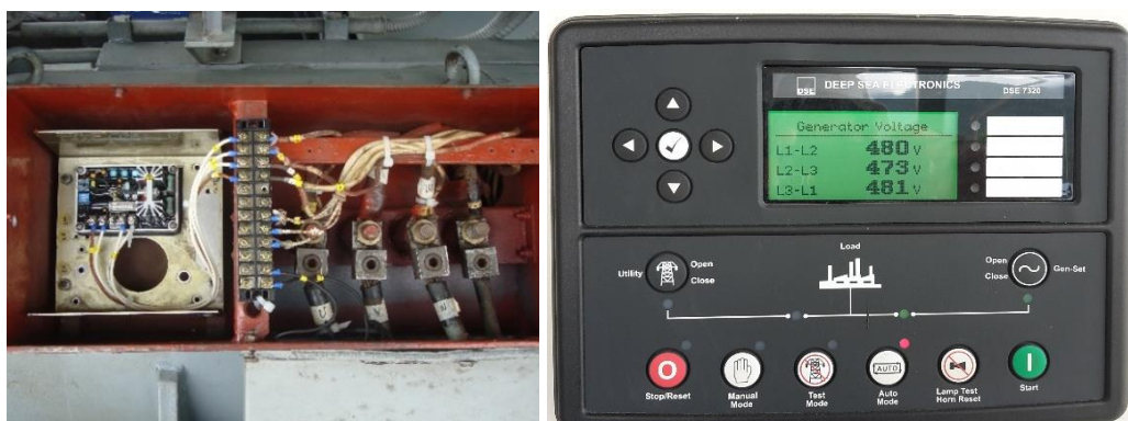
Figura 4. 40: Regulación de voltaje Fuente: EP Petroecuador (2016)
