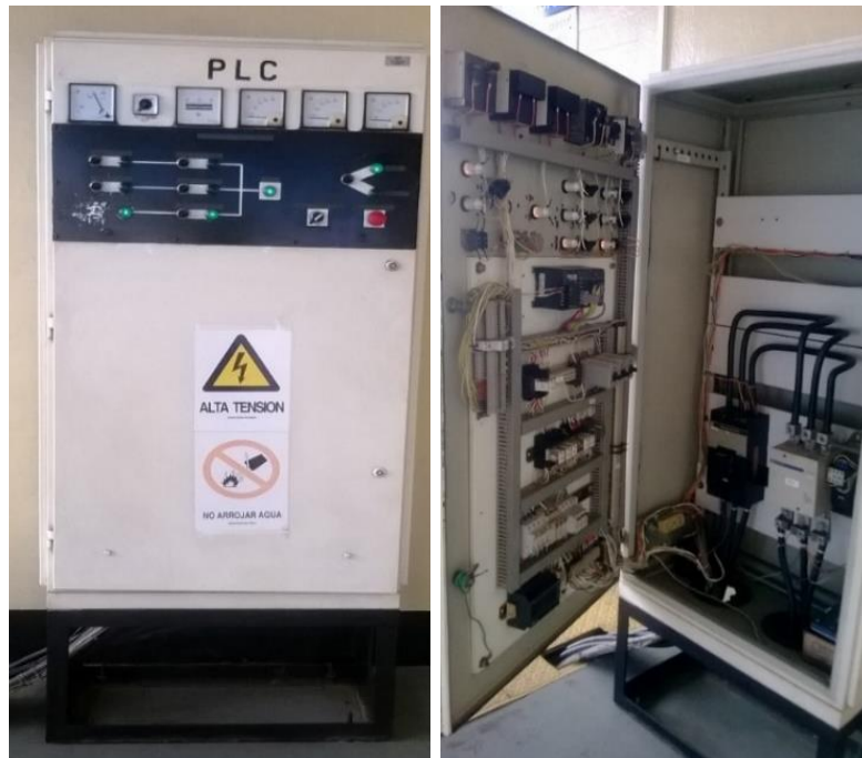
Figura 3. 13: Tablero PLC Fuente: EP Petroecuador (2015)
