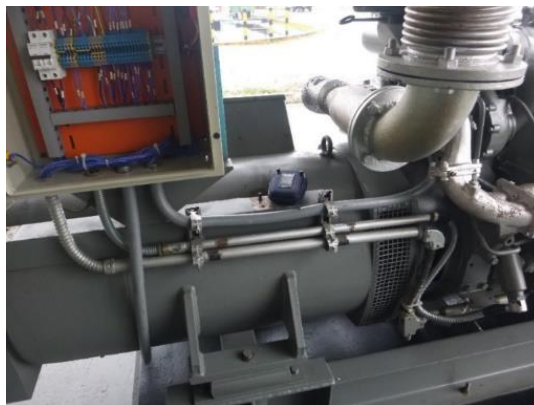
Figura 4. 31: Caja de conexiones del grupo electrógeno
