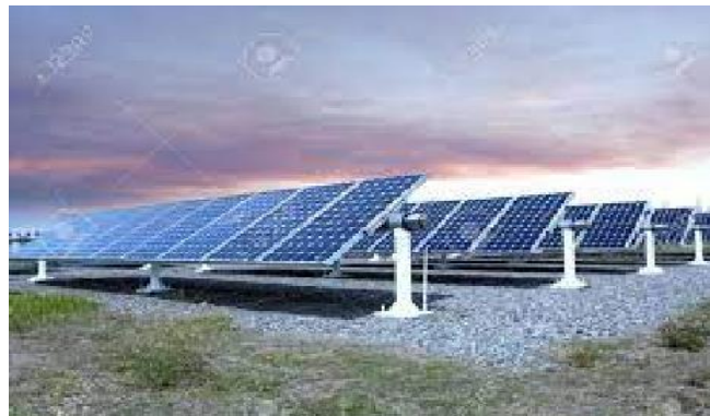
Figura 3.8. Estación de paneles fotovoltaicos [44].
