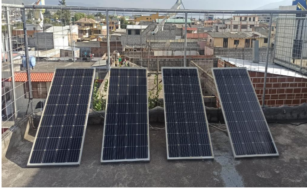
Figura B 7. Ubicación de paneles solares.
